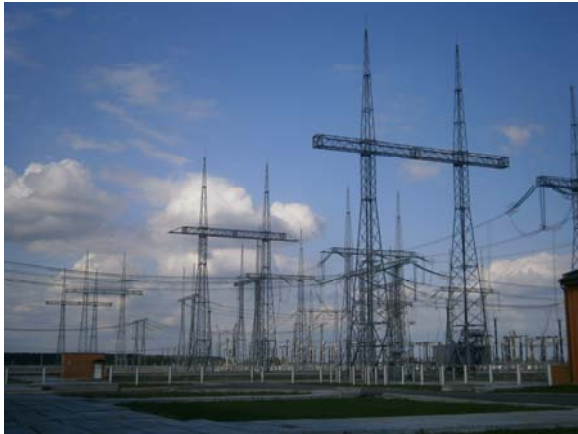
ПС 750кВ «Киевская»
