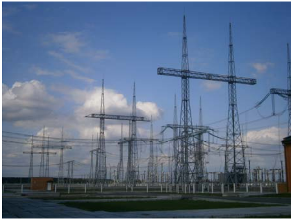
SS 750 kV "Kyivs'ka"
